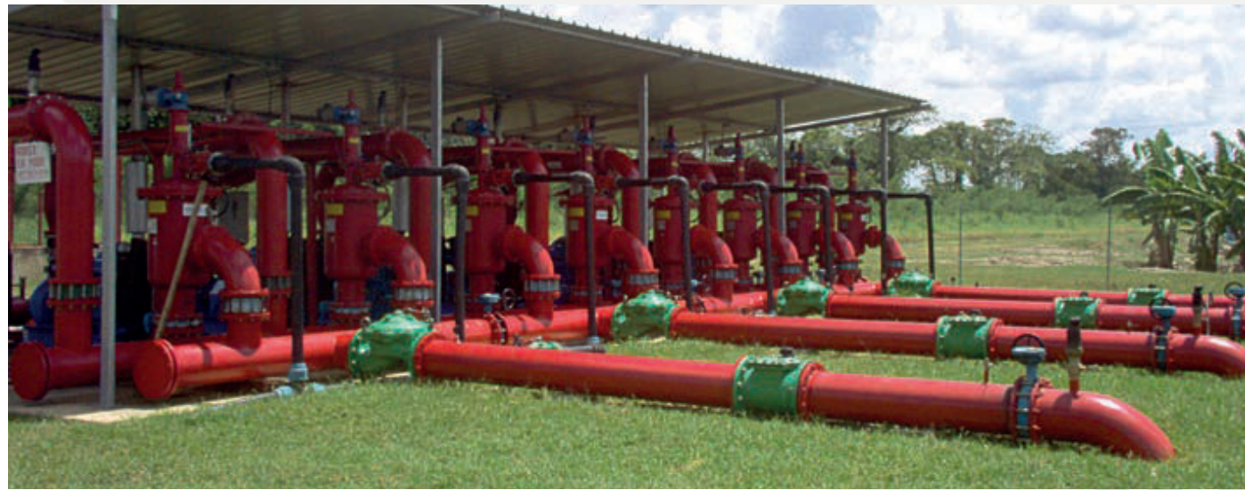
Station de pompage gros débit avec moteur thermique Pumping station delivering high flow rate with heat engine
